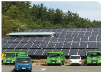
영천 그린환경센터 60kW
